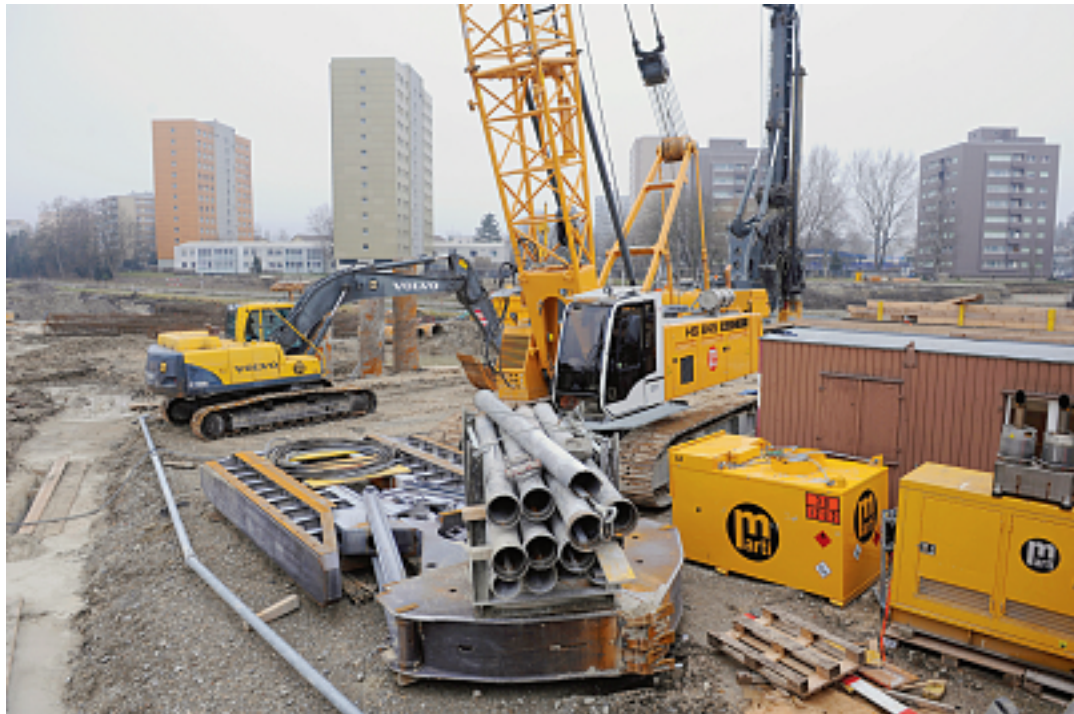
La construction de la branche Est du contournement de Bienne (ici aux Marais-de-Brügg) devrait être achevée à l'horizon 2016. Elle permettra de gagner directement la zone industrielle des Champs-de-Boujean. ARCHIVES
